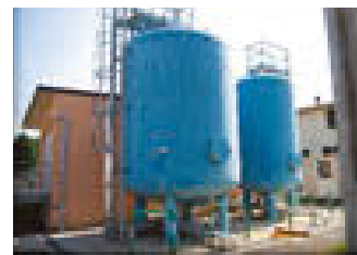
Impianti per la rimozione di ferro, manganese, arsenico e ammoniaca
