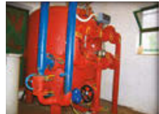
Impianto per la rimozione della torbidità
