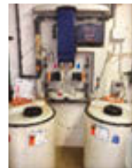
Impianti di disinfezione
