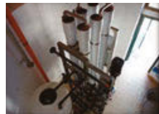
Impianti per la rimozione dei nitrati
