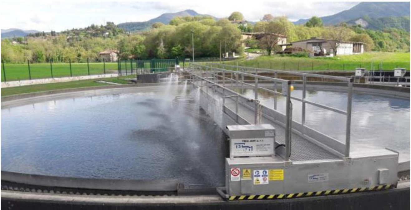
Uno degli impianti gestiti da Acque Bresciane, prima utility italiana di gestione del ciclo idrico a trasformarsi in una società benefit
