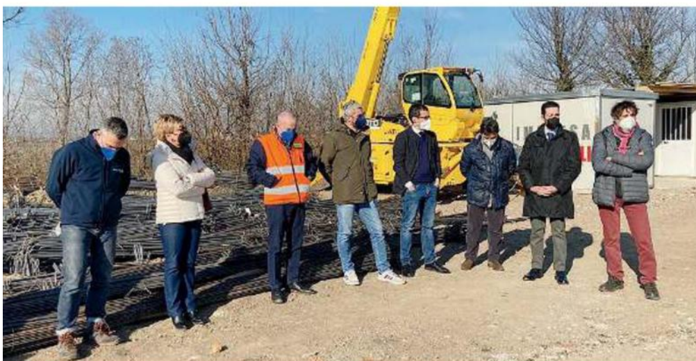
La presentazione. Amministratori e tecnici di Acque Bresciane ieri all'inaugurazione del cantiere
